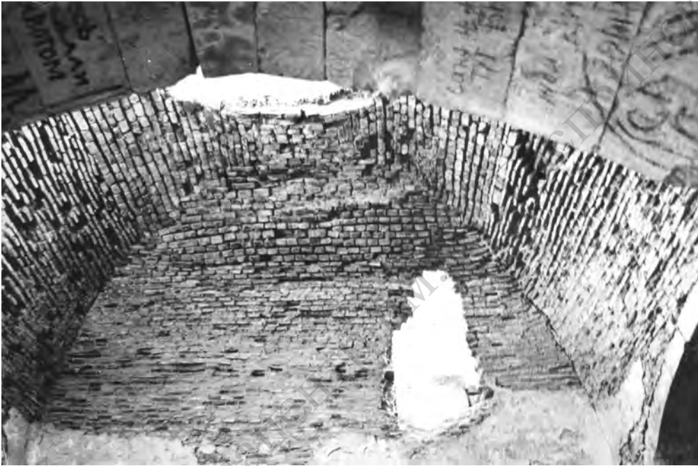
Разрушенный плинфтовый свод южного зала трапезной в 1993 году.
