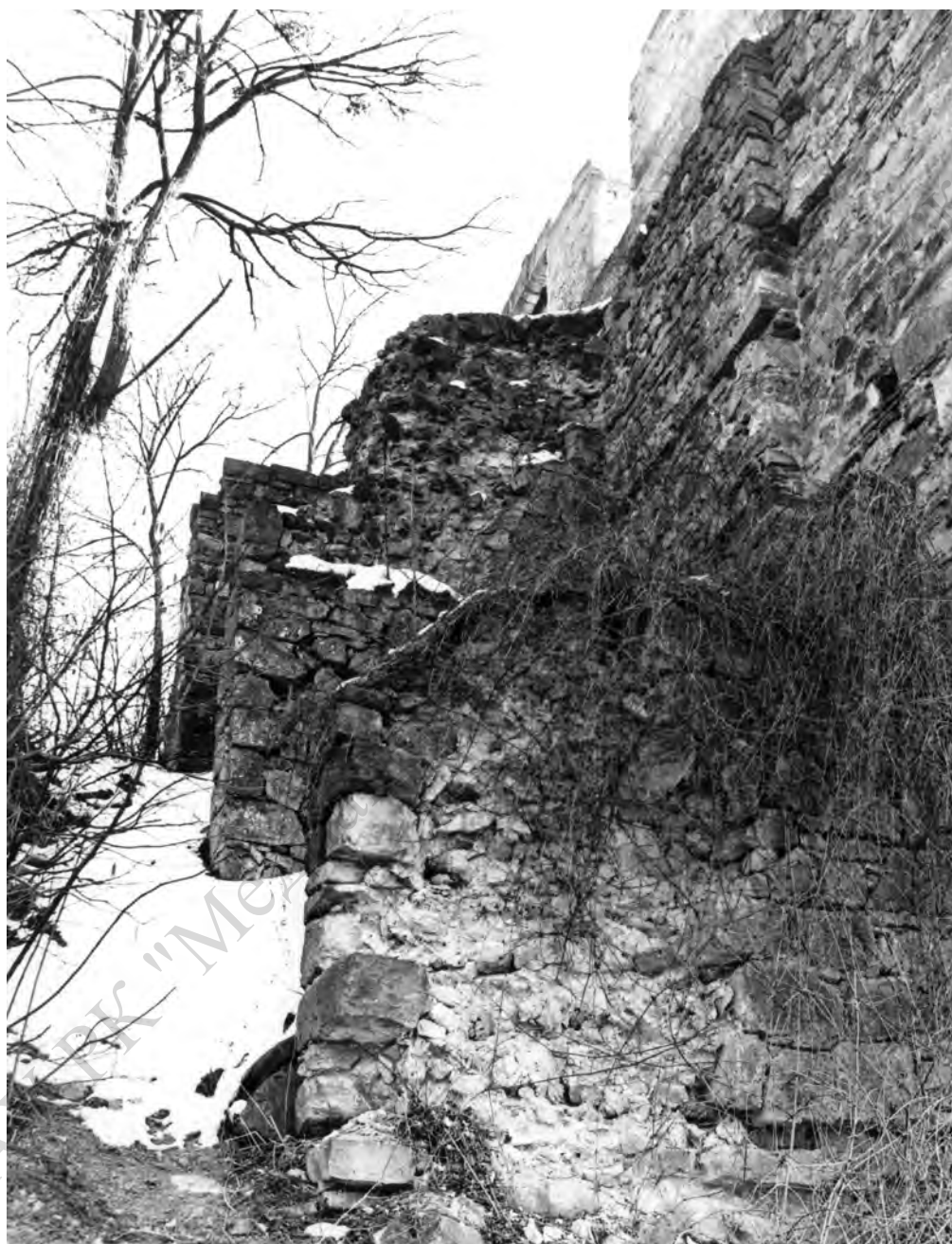
Северная стена трапезной с разрушенными контрфорсами. Фото 1992 года.
