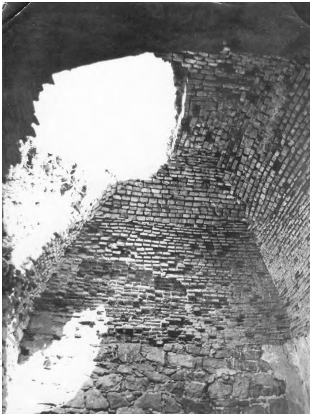
Разрушенный плинфовый свод южного зала трапезной в 1993 году.
